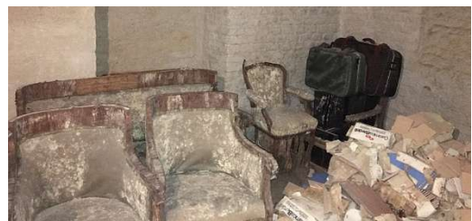
Abbildung 10 Verschimmeltes Mobiliar in nachträglich „abgedichtetem“ Kellerraum in einem Wiener Altbau
