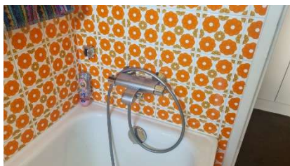
Abbildung 7 auch korrekt verlegte Installationen in der Wand können Schimmelbefall bewirken
