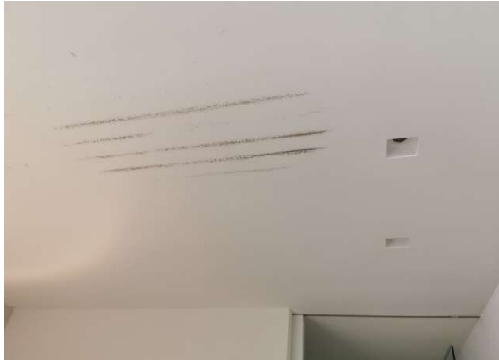
Abbildung 5 Charakteristischer streifenförmiger Schimmelbefall bei Deckenkühlung durch falsch situierten Taupunktfühler
