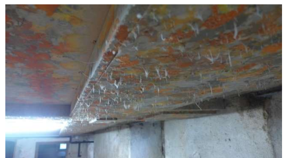
Abbildung 3 Sommerkondensation durch die Auswahl von leicht besiedelbaren Dämmmaterialien (Weichfaserplatten) im Kellerbereich
